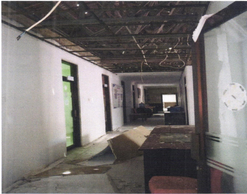
Kondisi Bangunan di RSUD Tagulandang
